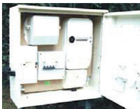
Comptage triphasé, avec disjoncteur type S, disjoncteur 30 mA et prise en aval
