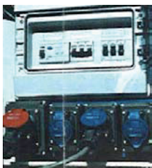
Protection différentielle 30 mA, associée à des prises ou borniers IP2X ou de classe 2 (= enveloppe ne permettant pas le contact direct des pièces sous tension).
